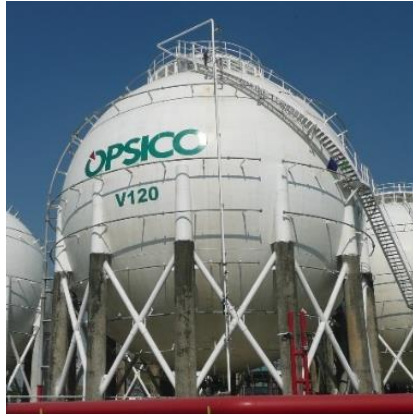
Gambar 2.2 Spray Nozzle pada Spherical Tank
