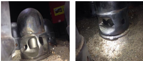
Gambar 1. 1 Air cap Nozzle yang mengalami failure di furnace
