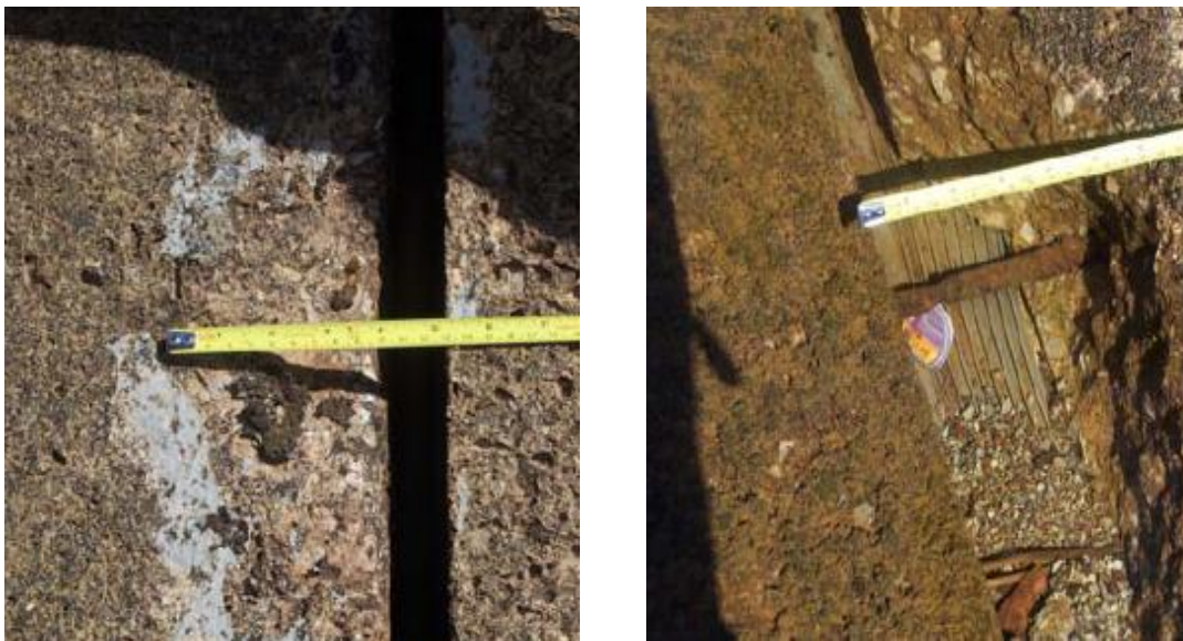
Gambar 2.27. Kerusakan Pada Larona Canal
