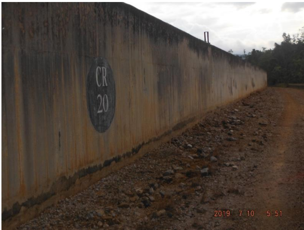
Gambar 4.3. Tidak ada tumpahan air pada crossing #20 selama pengetesan 180 MW selama beberapa jam.
