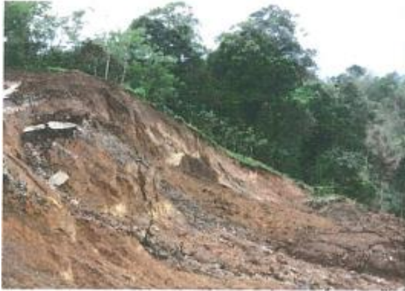
Gambar 1.3 Kondisi longsor di KM 5 (Sumber: PT. PLN (Persero))
