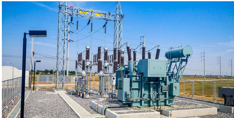
Gambar 2. 2 Gardu pada Sistem Transmisi Sumber : (DNV.GL, n.d.)
