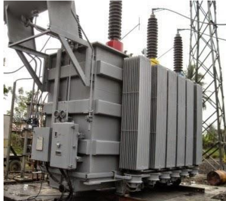
Gambar 2. 4 Transformator pada Gardu Sumber : (Warriornux, 2017)
