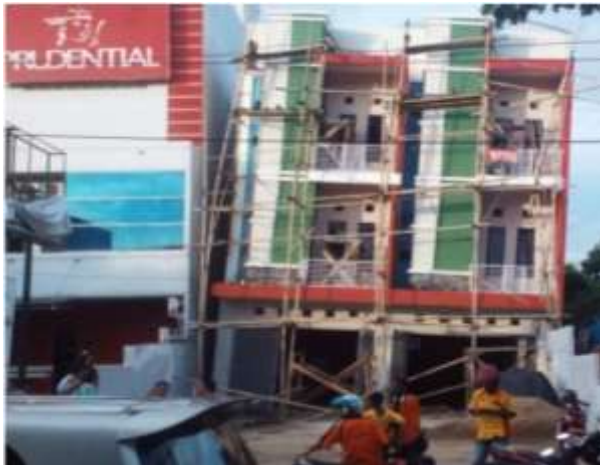
Gambar 1.1 Ruko tiga lantai mengalami kemiringan dengan pondasi friction pile di Kota Banjarmasin (Sumber: google image )
