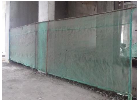
Gambar 2.27 Safety Net (Sumber: Dokumentasi Pribadi)
