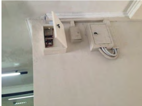
Saklar Listrik Gedung Lt.2 Kanwil DJPBN
