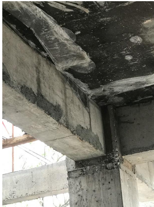
Gambar 5. 9 Joint Kolom yang Keropos dan Telah Ditambal
