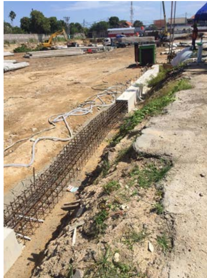
Gambar 5.2 Kesalahan Pemancangan Sheet Pile
