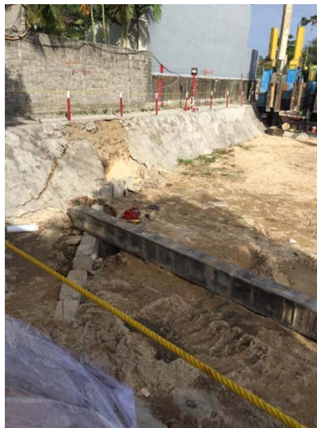
Gambar 5.1 Kesalahan Pemancangan Sheet Pile
