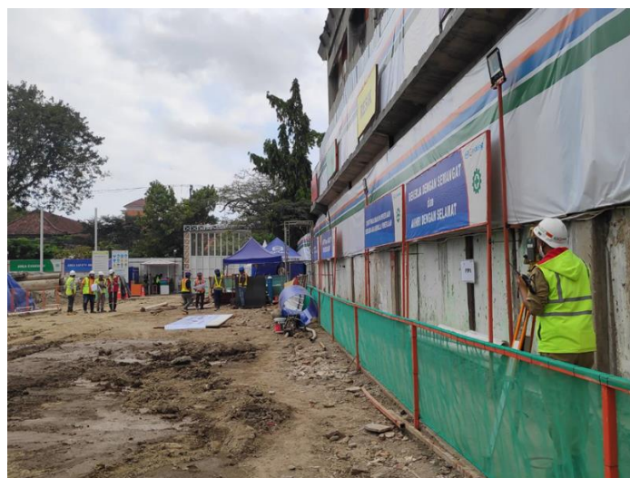
Gambar 94 Penentuan Titik Reaction/Unused pile (Sumber Foto Lapangan)
