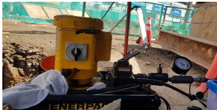
Gambar 109 Pressure Gauge dan Pompa (Sumber Foto Lapangan)
