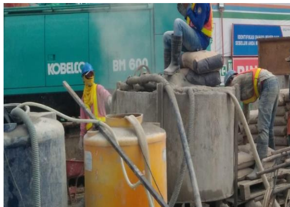
Gambar 46 Mixer dan Pompa Bentonite (Sumber Foto Lapangan)
