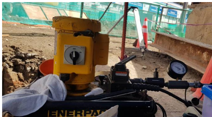
Gambar 88 Pressure Gauge dan Pompa (Sumber Foto Lapangan)
