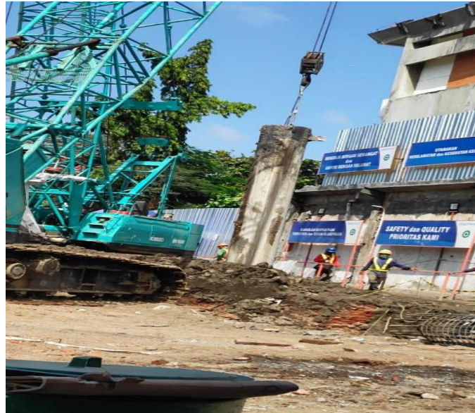
Gambar 22 Casing CPB (Sumber Foto Lapangan)
