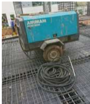
Gambar 5. 17 Air Compressor Sumber: Dokumentasi Penulis, 2020.
