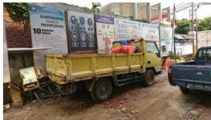
Gambar 3. 3 Rambu – Rambu K3 dan Lain – Lain Sumber: Dokumentasi Penulis, 2020.
