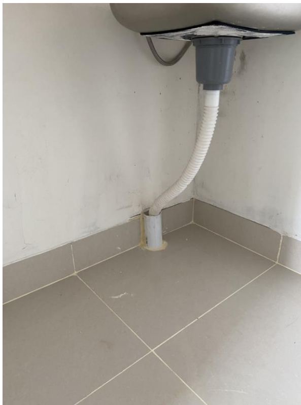
Gambar 5.4 Contoh Defect pada pipa buangan zink yang terlalu masuk
