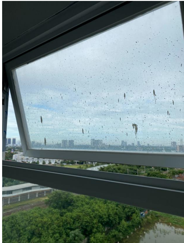
Gambar 5.2 Contoh Defect tidak adanya handle jungkit pada Jendela
