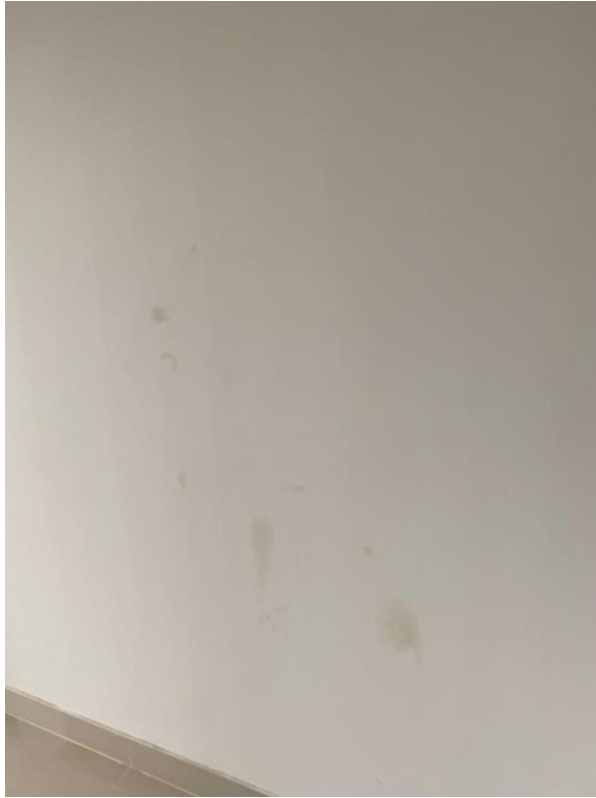
Gambar 5.5 Contoh Defect pada cat dinding unit yang kotor maupun belang
