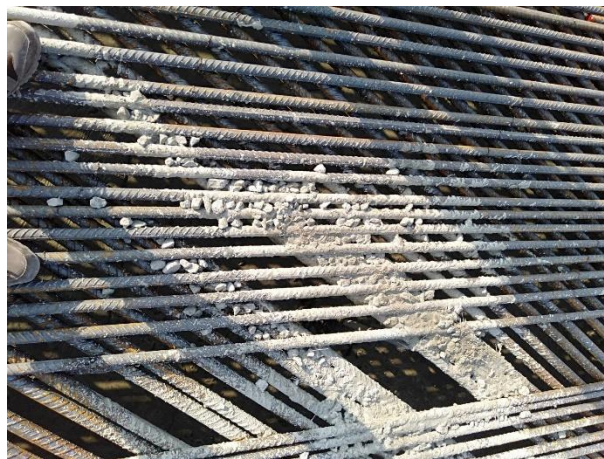
Gambar 3.78 Penampakan Agregat yang Tertahan pada Tulangan Box Culvert Diagonal Selatan
