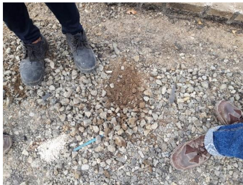
Gambar 3.64 Permukaan Base Course A yang Mengalami Segregasi
