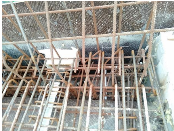
Gambar 3.24 Angkur Hidup Tendon Arah Lateral Jembatan Utama
