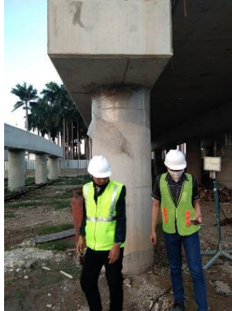
Gambar 3.79 Posisi Pile Head yang Tidak Sentris terhadap Pile di Bawahnya
