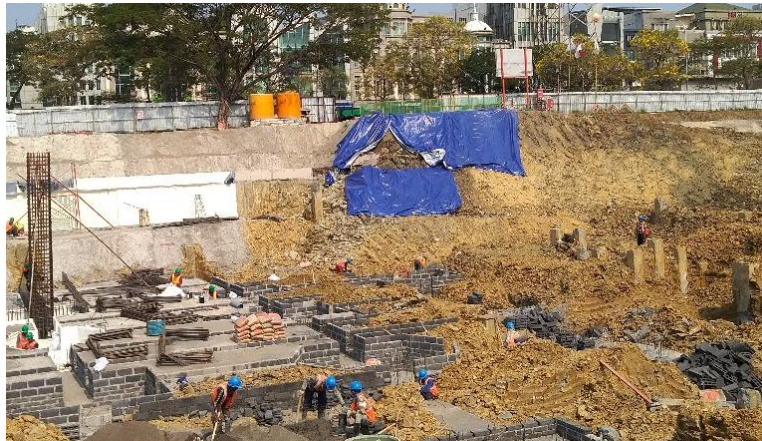
Gambar 3.31 Longsor pada ramp dump truck
