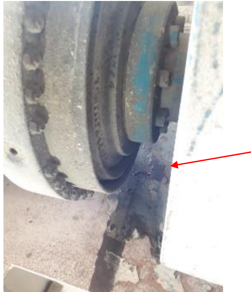
Gambar 5.2 Kebocoran Oli Pada Coupling High Speed Conveyor
