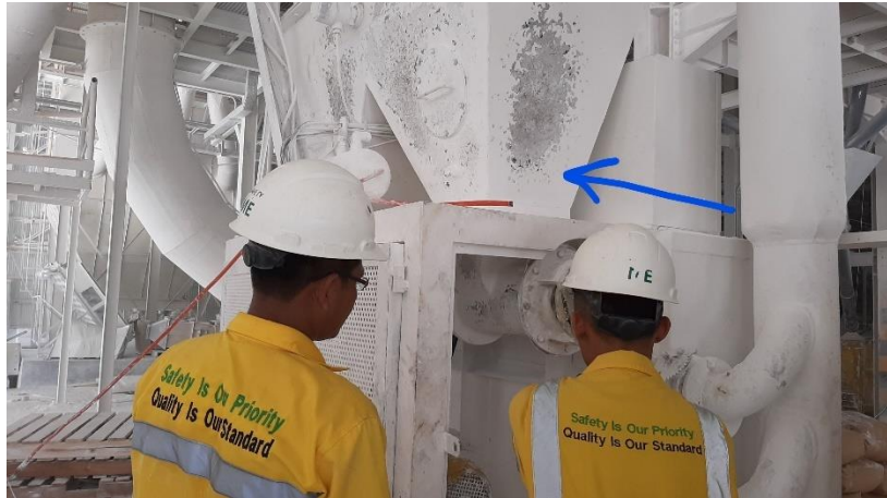
Gambar 3. 26 Bagian Penghubung Antara Mesin Packing Dengan Konveyor
