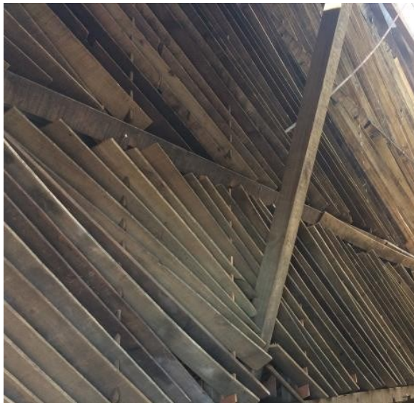
Gambar 2.7 Fill cooling tower (Sumber: Dokumentasi penulis)
