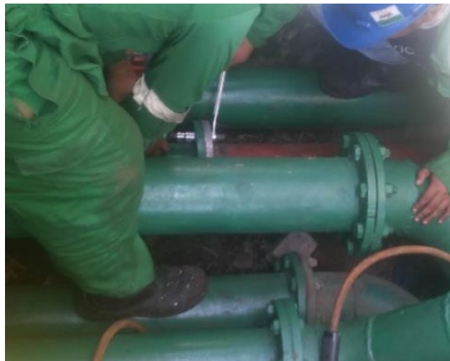
Gambar 2.3 Instalasi pipa air pendingin (Sumber: Dokumentasi penulis)
