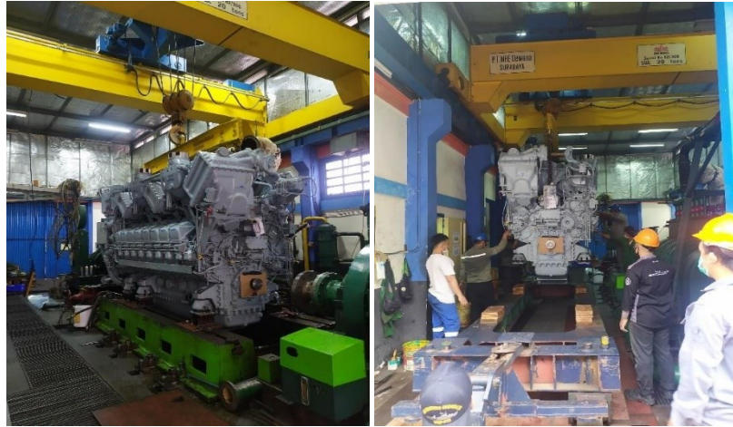
Pelepasan engine KRI Teluk Celupan Bawang dari dudukan di Bengkel Uji Motor
