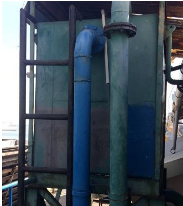
Gambar 2.12 Service tank (Sumber: Dokumentasi penulis)
