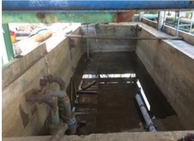
Gambar 2.5 Hot water basin (Sumber: Dokumentasi penulis)
