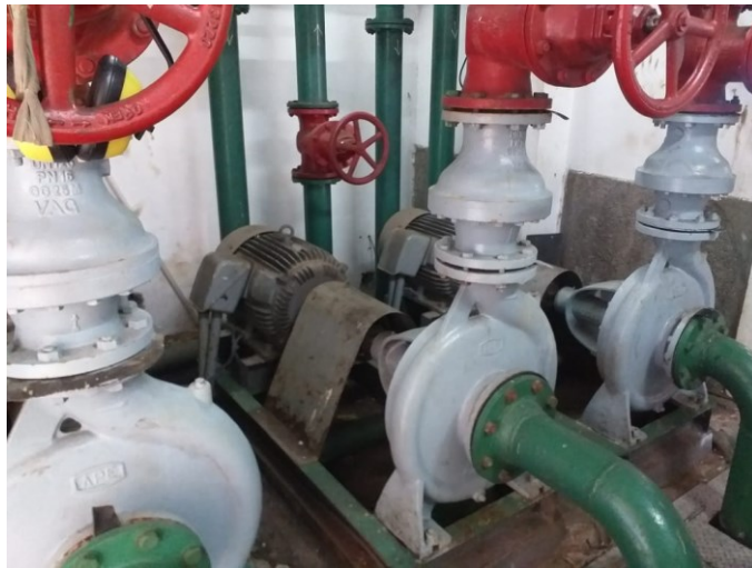
Gambar 2.4 Pompa coldwater (Sumber: Dokumentasi Penulis)
