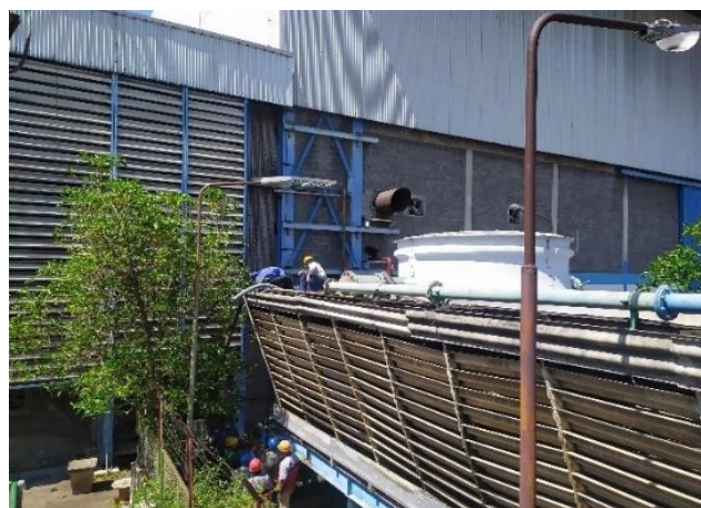
Gambar 2.6 Cooling tower bengkel uji motor PT. PAL Indonesia (Persero) (Sumber: dokumentasi penulis)
