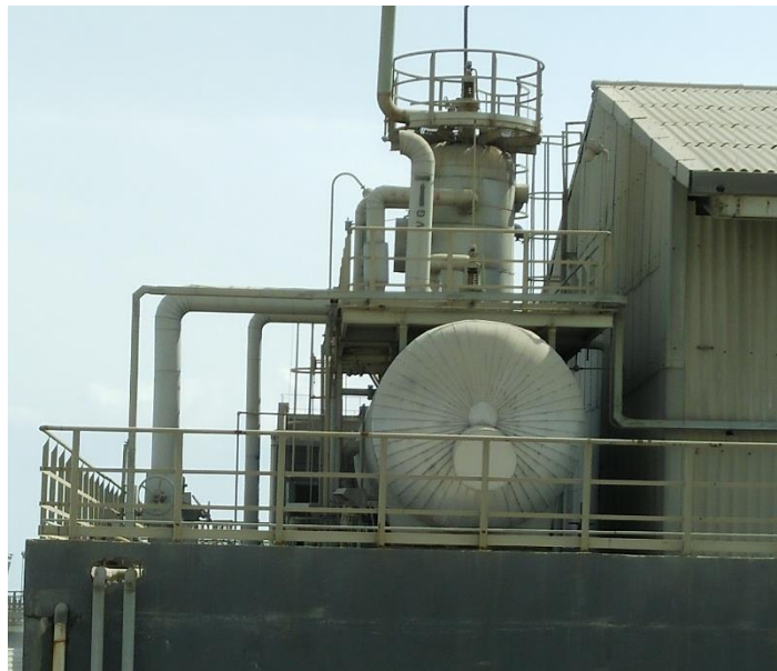
Gambar 2.7 Deaerator pada SA Plant di PT Petrokimia Gresik
