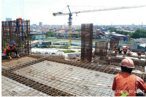
Gambar 4.12 Pemasangan Tulangan Wire Mesh M7 Sumber : Dokumen PT. PP Grand Dharmahusada Lagoon
