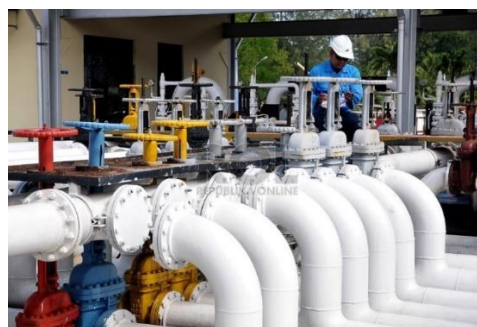
Gambar 6 Rumah Pompa Terminal Curah Cair
