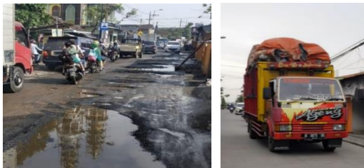
Gambar 1.1 Kondisi Kerusakan Jalan Eksisting di Jl. Raya Damarsi (kiri), dan kendaraan dengan muatan yang melebihi kapasitas (kanan).
