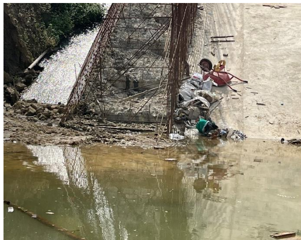
Gambar 5.5 Genangan di kaki bangunan pelimpah akibat dari hujan
