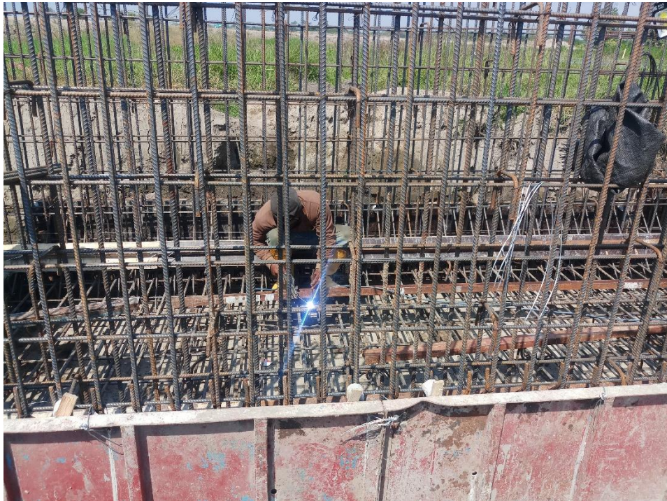
Gambar 8. 1 Pekerja yang Tidak Menggunakan APD Lengkap
