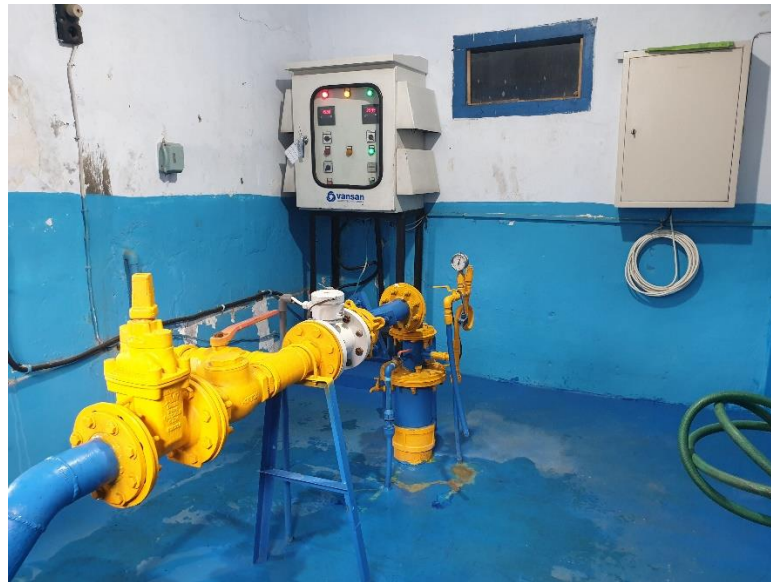
Lokasi Pompa Sistem Distribusi Summersari
