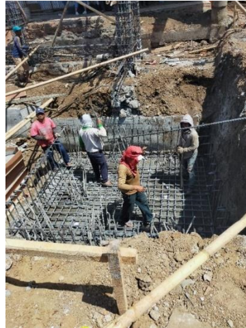
Gambar 8. 1 Pekerjaan yang tidak memakai APD lengkap
