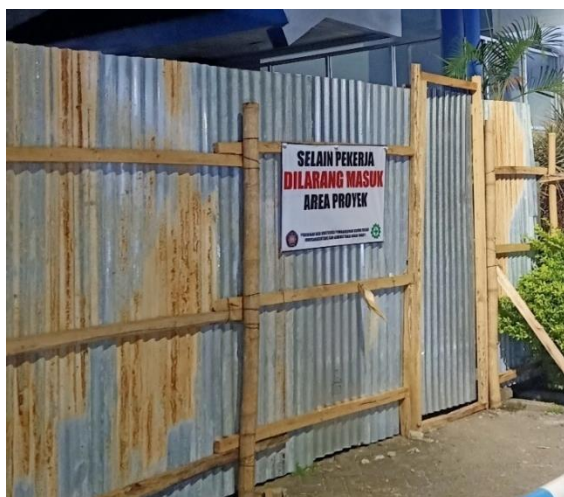
Gambar 4.41 Papan informasi proyek
