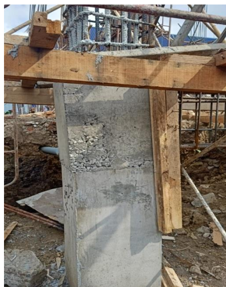
Gambar 8. 2 Keroposnya beton pada kolom
