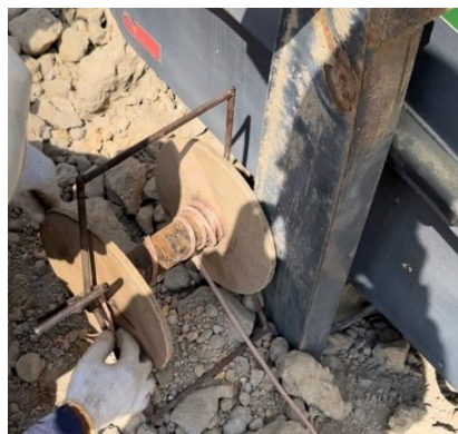
Gambar 4. 21 Kabel Gulung (Sumber: Dokumentasi Penulis, 2021)
