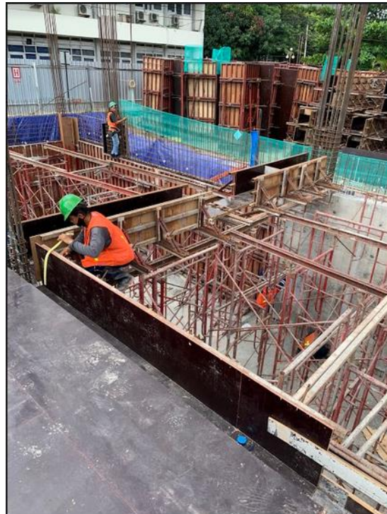
Gambar 4. 38 Bekisting balok lantai 1 yang kurang sesuai dengan perencanaan langsung dilakukan perbaikan
