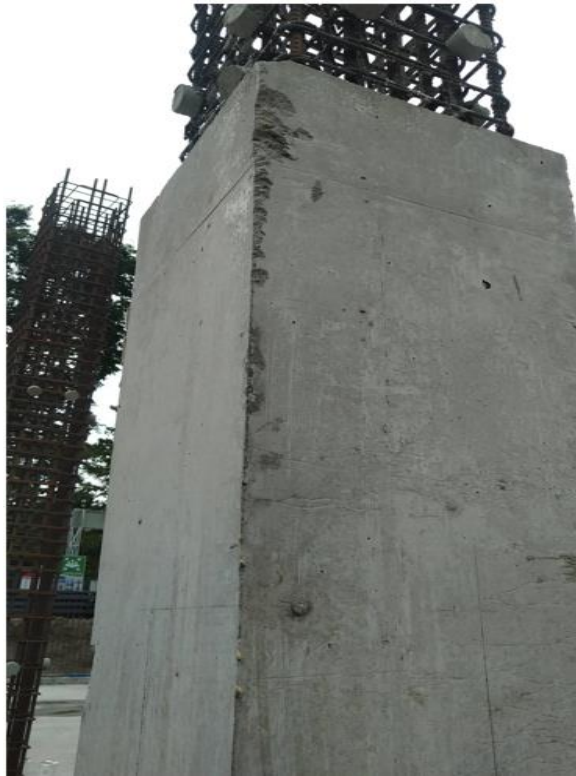
Gambar 4. 39 Terjadi keropos pada kolom lantai dasar setelah pelepasan bekisting
