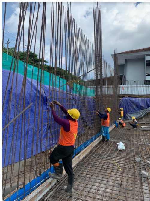
Gambar 4. 35 Pekerja besi tidak menggunakan sarung tangan saat melakukan pembesian
