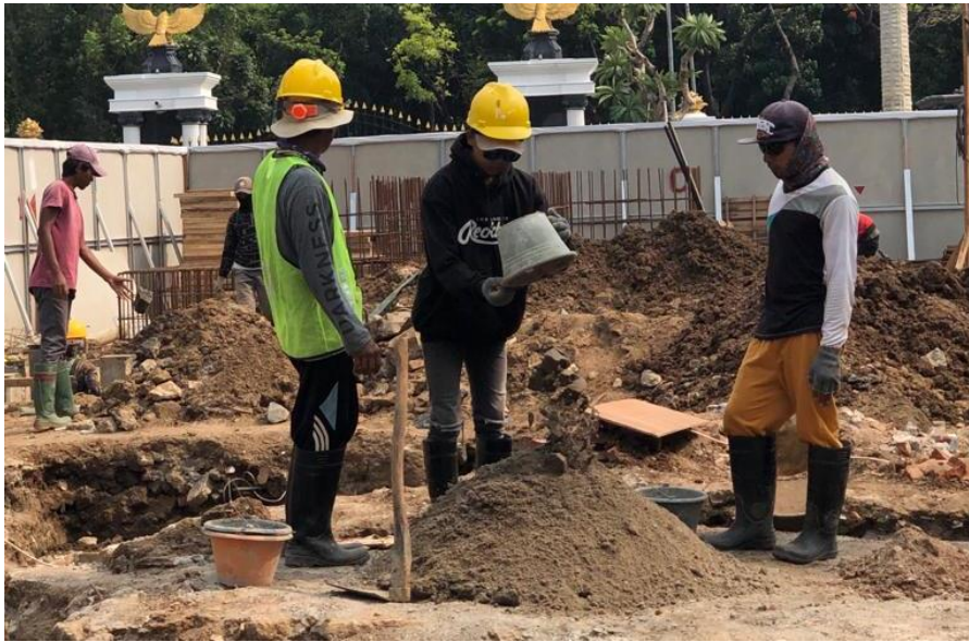
Gambar 4.5 Pekerja tidak memakai APD
