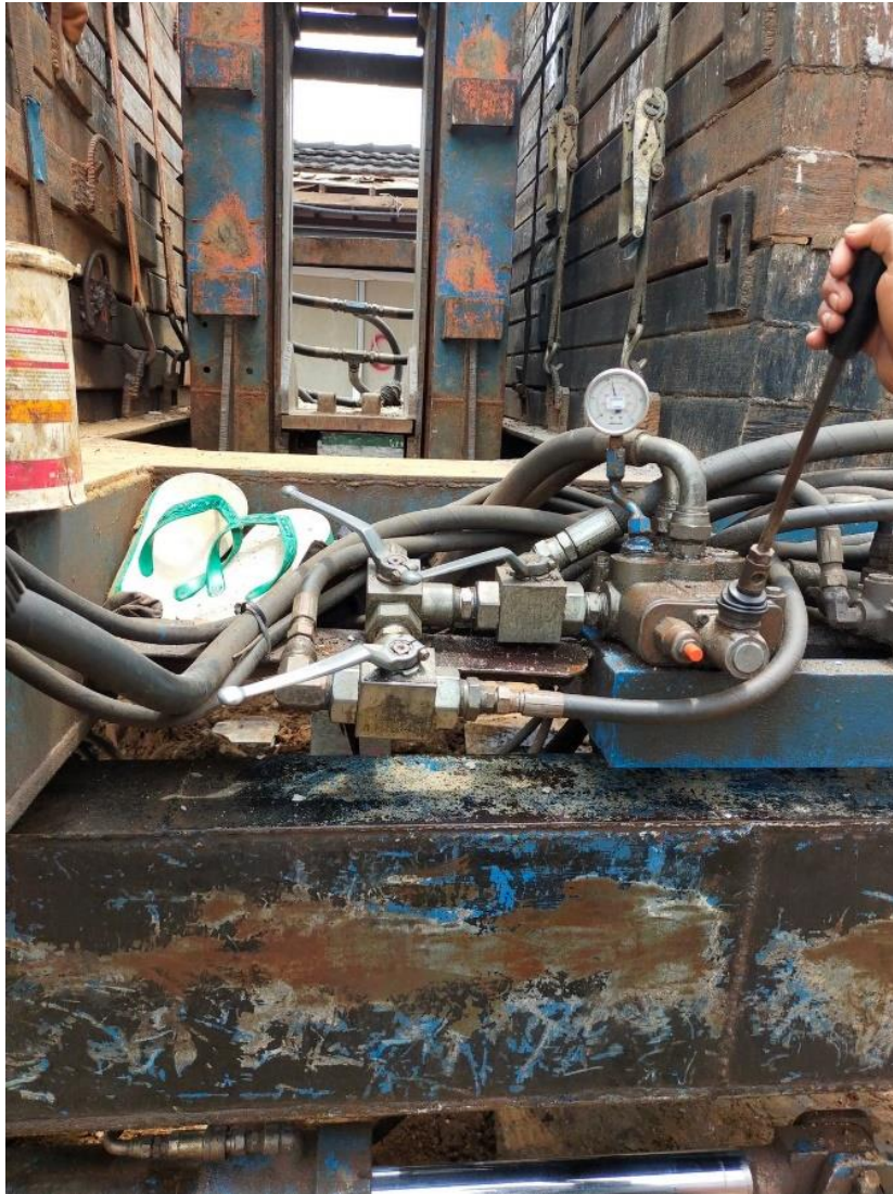
Gambar 3.8 Manometer oil pressure pada ruang kontrol
