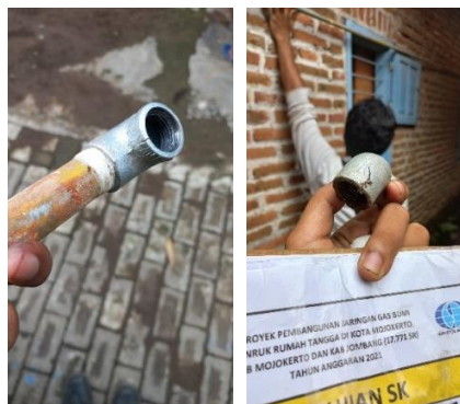
Gambar 3.1 Material yang mengalami kerusakan
