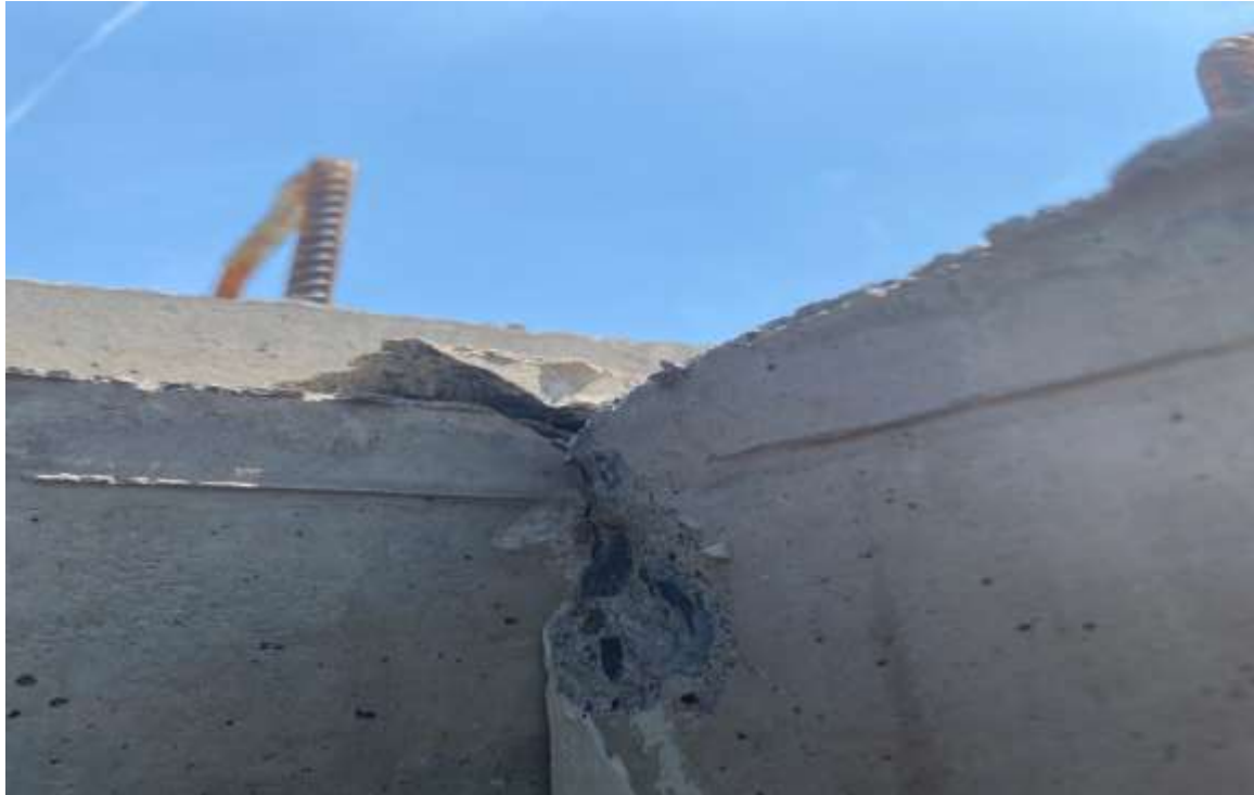
Gambar 3. 1. Retak Pada Girder
