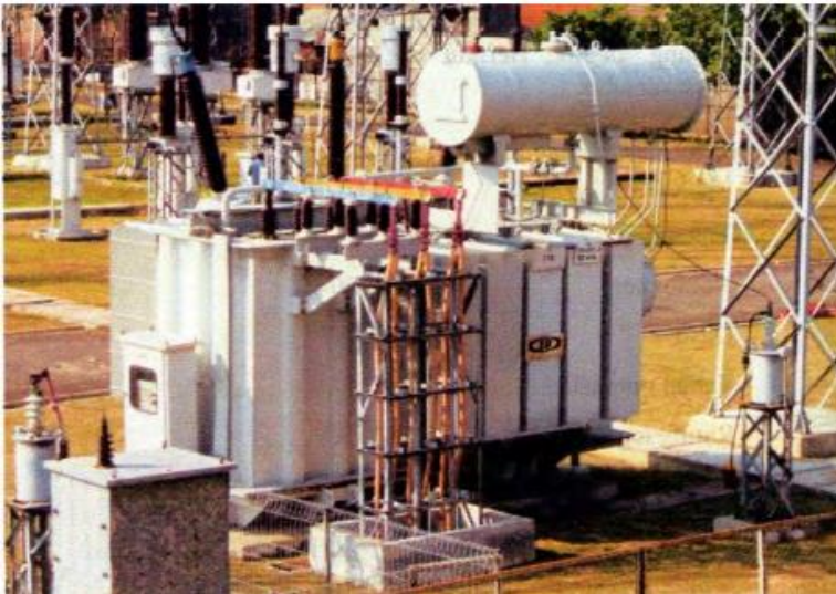
Gambar 3. 1 Transformator Daya 150 kV di Gardu Induk Kenjeran
