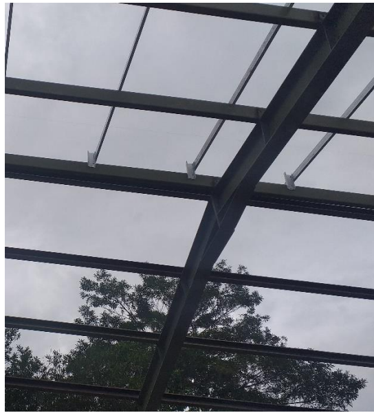
Gambar 4.64. Sambungan baut pada kuda-kuda (Sumber : Dokumentasi pribadi)
