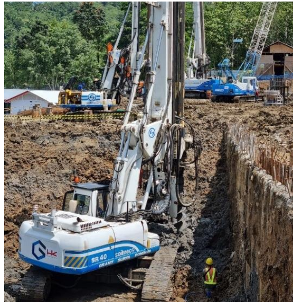
Gambar 4.81. Mesin bor (Sumber : Dokumentasi pribadi)
