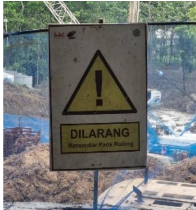
Gambar 3.13. Rambu-rambu dilarang bersandar pada railing (Sumber : Dokumentasi pribadi)
