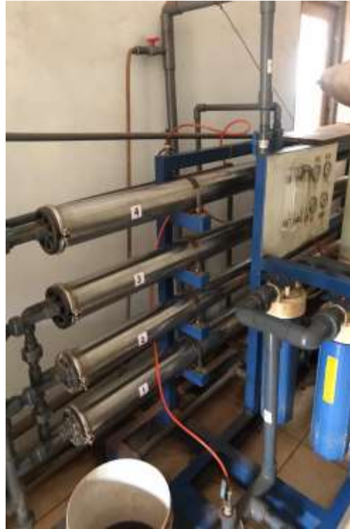
Gambar 2.2 Reverse Osmosis Spesifikasi Reverse Osmosis
