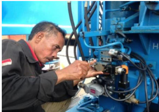
Gambar 5.7 Pengecekan dan Perawatan pada Rectalinier Potentiometer , Solenoid Valve / DCV dan Proportional Valve pada Hoist
