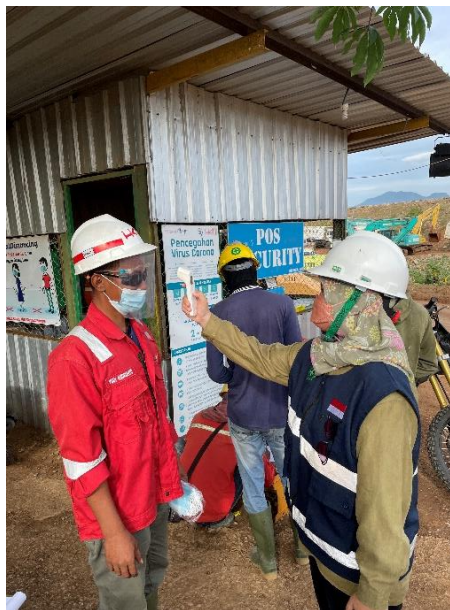
Gambar 3. 13 Persiapan Toolbox Meeting di Proyek Pembangunan Bendungan Semantok Paket II (Sumber: Dokumentasi Pribadi)
