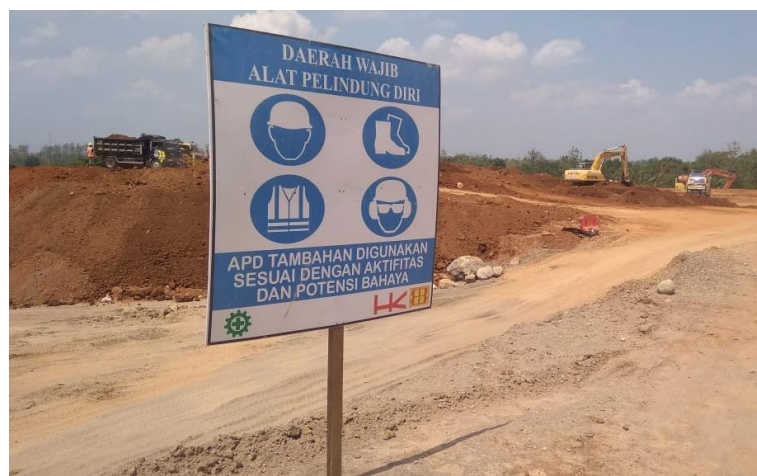
Gambar 3. 8 Rambu Peringatan Menggunakan APD (Sumber: Dokumentasi Pribadi)
