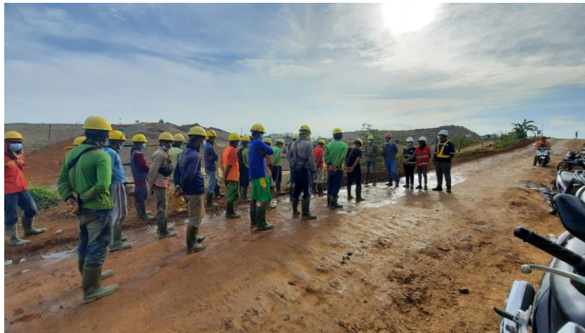
Gambar 3. 12 Toolbox Meeting di Proyek Pembangunan Bendungan Semantok Paket II (Sumber: Dokumentasi Pribadi)
