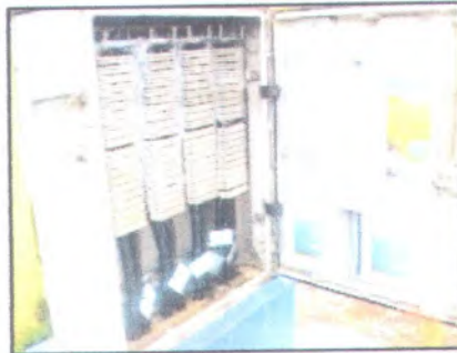
Gambar 4.12 Rumah Kabel (RK)
