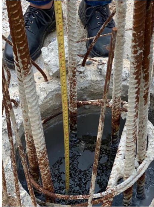
Gambar 3.2 Spun Pile Terendam Air Hujan
