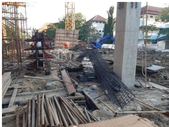
Gambar 3.32 Keadaan Kolom Sesudah Roboh
