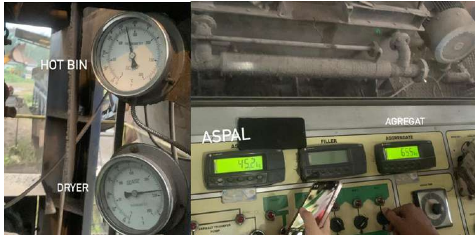
Gambar 3. 34 Pengontrol Suhu dan Timbangan di Operator Room
