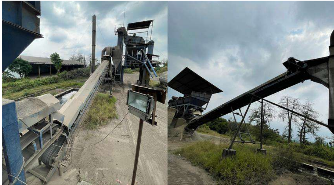
Gambar 3. 23 Cold Elevator AMP PT Surya Marga Utama
