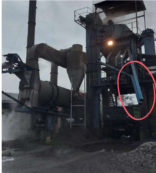
Gambar 3. 32 Overflow Pipe AMP PT Surya Marga Utama
