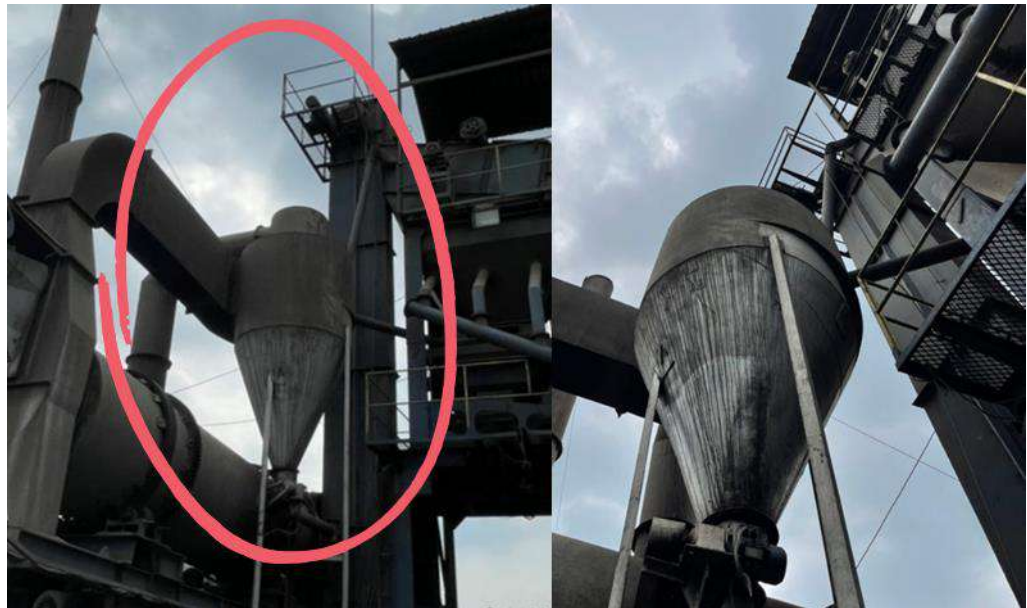
Gambar 3. 25 Dust Collector AMP PT Surya Marga Utama
