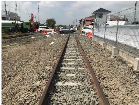
Gambar 2 23 Dokumentasi Pagar BRC pada STA 105+650
