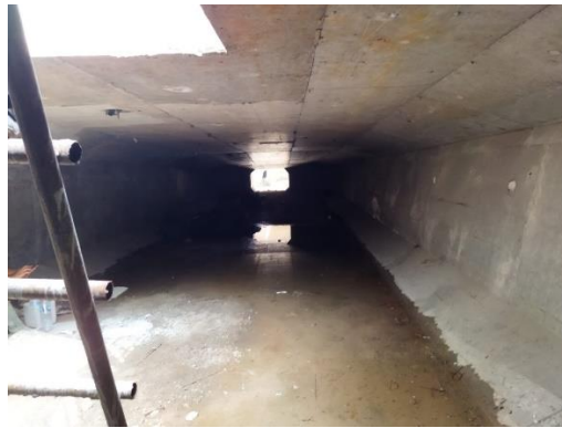
Gambar 6. 2 Kondisi inner box girder yang terendam air
