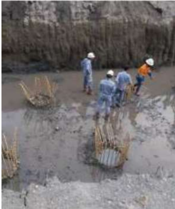
Gambar 3.3 Genangan Air di Area Pekerjaan
