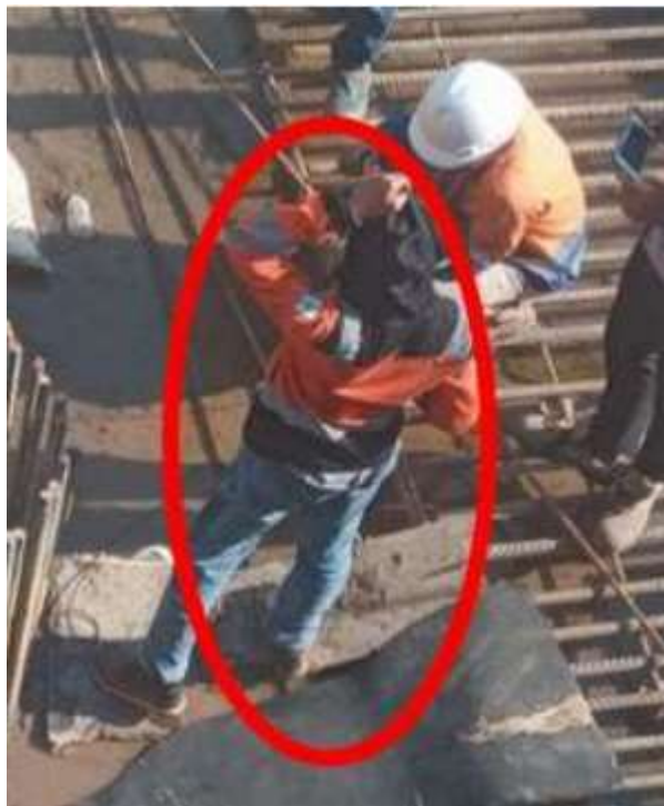
Gambar 3.2 Pekerja Tidak Menggunakan APD Sesuai Standar
