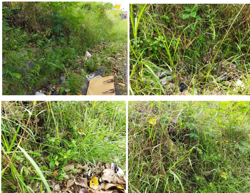
Gambar 17. Saluran Eksisting Pasangan Batu Rusak
