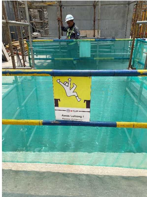
Gambar 90. Rambu Peringatan Lubang
