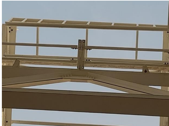
Gambar 7. 5 Pemasangan Fasad Kaca yang Tidak Sesuai dengan Marking
