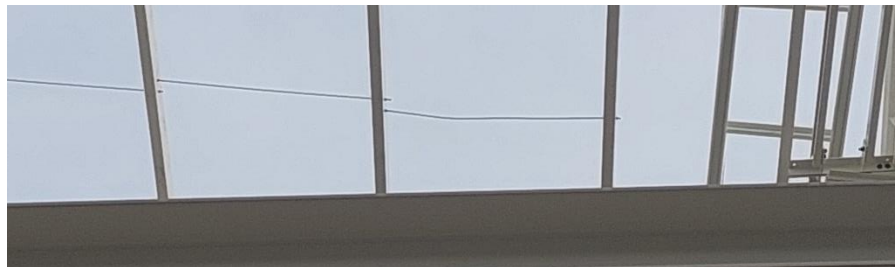
Gambar 7. 6 Sagrod Tidak Lurus Terpasang di Purlin
