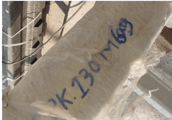
Gambar 7. 2 Perbedaan Markingan Fabrikasi dengan Kondisi di Lapangan
