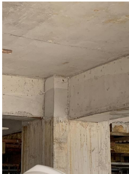
Gambar 3.1 Terjadinya Cold Joint pada balok
