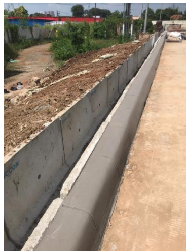
Gambar 5.3 Drainase tipe U-ditch dan Kanstin
