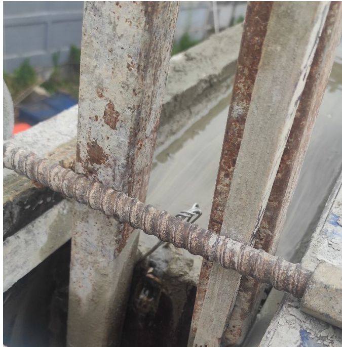
Gambar 3.33 Bleeding Beton Pekerjaan Parapet
