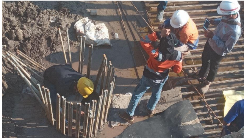
Gambar 5.2 Pekerja tidak menggunakan safety helmet
